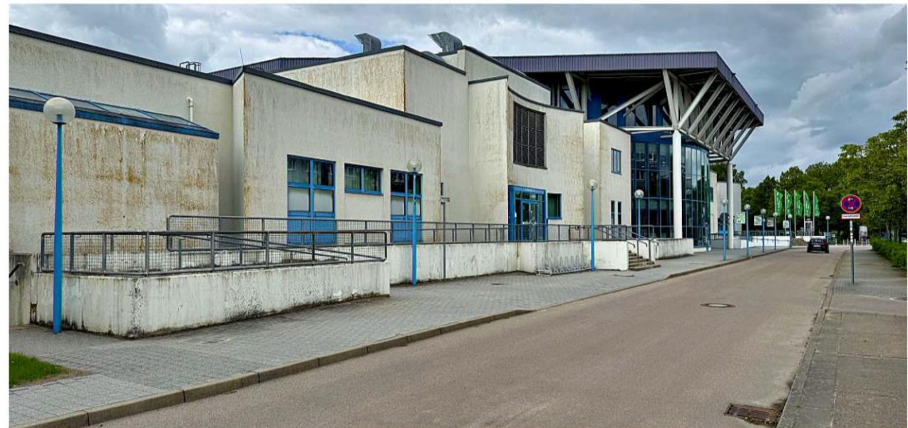
Schon von außen ist zu erkennen: Die Fassade des Jahnsportforums hatte schon bessere Zeiten.
