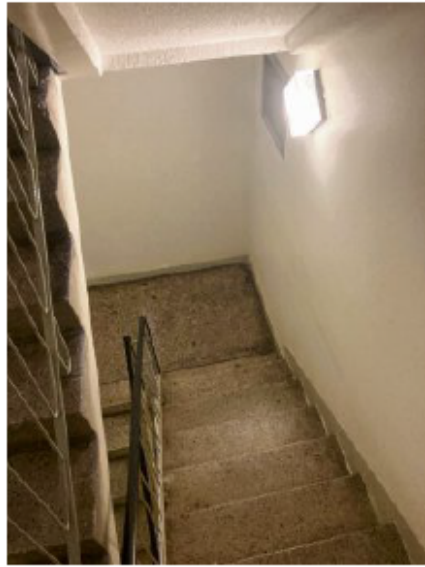
Laut Neuwoges ist im kargen fensterlosen Treppenhaus permanentes Licht notwendig.
