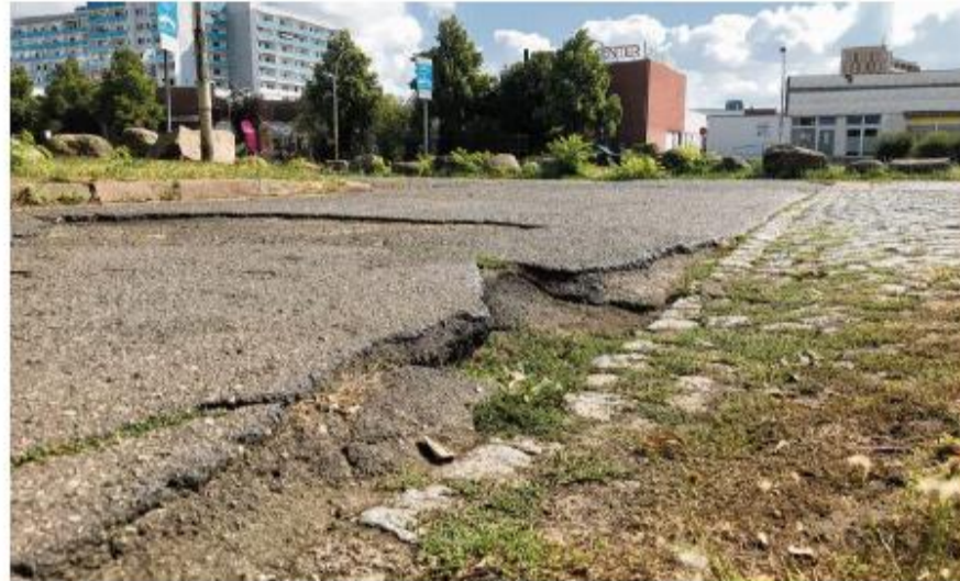
Die tiefen Löcher in der Ikarusstraße sorgen bei den Anwohnern für Ärger. Einige sollen nun ausgebessert werden. FOTO: PABLO HIMMELSPACH
