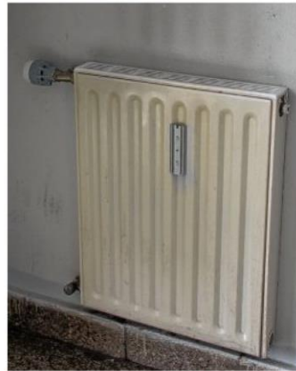
Damit es auch im Sommer warm bleibt: Dieser Heizkörper ist ein Ärgnis für die Mieter.
