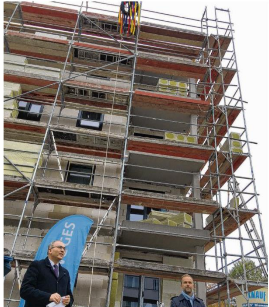
Neuwoges-Geschäftsführer Frank Benischke (l.) und Oberbürgermeister Silvio Witt freuen sich über das gut voranschreitende Bauprojekt.
