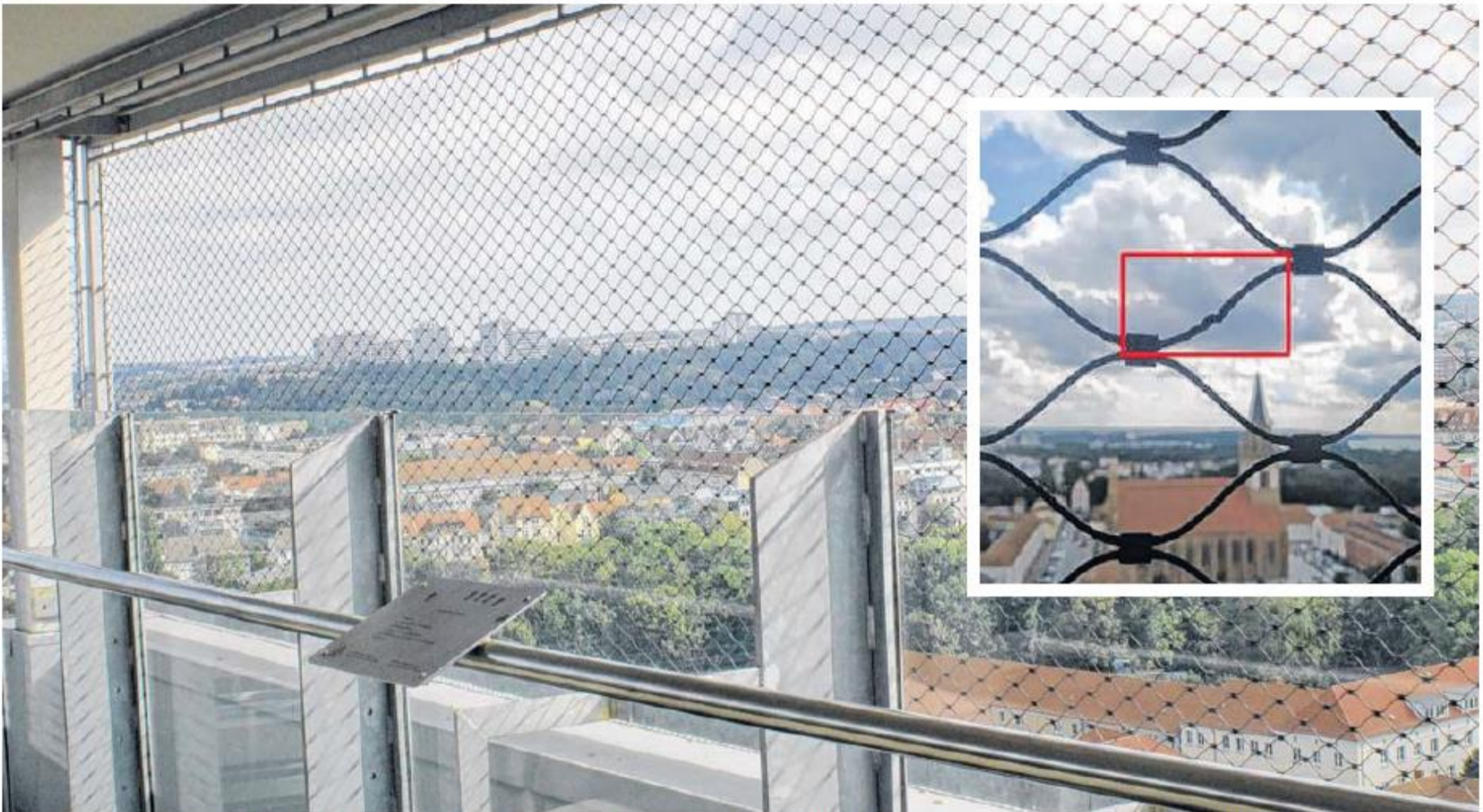
Nur wer ganz genau hinschaut, kann den Schaden am Sicherheitsnetz des HKB finden. Die Plattform bleibt also weiterhin für Besucher geöffnet.
