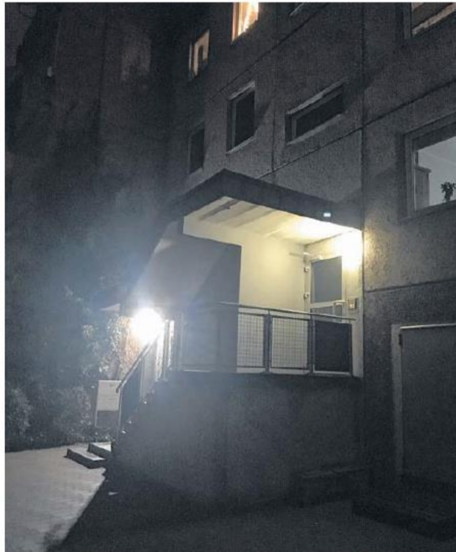
Licht am Fuße der Treppe gab es monatlang nur mit Verzögerung.
