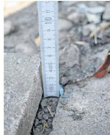
Mehrere Zentimeter beträgt der Höhenunterschied zwischen den einzelnen Betonplatten teils in der Hufelandstraße.
