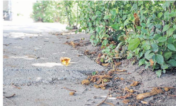
Ohne den von Anwohnern aufgebrauchten Beton, wäre diese Stolperfalle in der Hufelandstraße noch gefährlicher.
