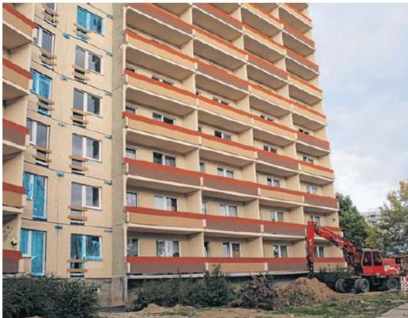
Wo jetzt noch Bretter sind, kommen Balkons hin: So werden auch die Keilraumwohnungen aufgewertet.
