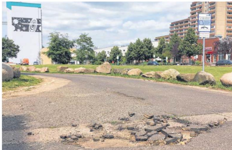
An diesem Schlagloch in der Ikarusstraße haben sich große Asphaltstücke gelöst.
